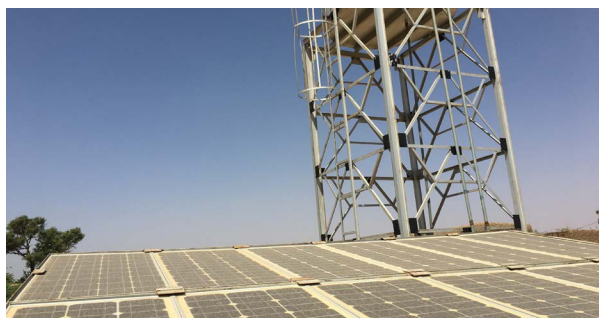
Eine solarbetriebene Wasserpumpe mit Wasserspeicher
