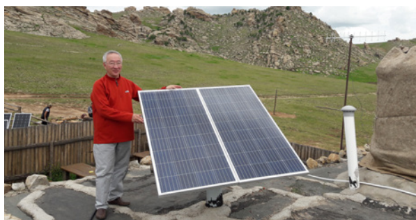
Eine neu errichtete PV Anlage in der Mongolei.
