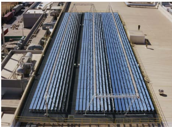
Solarthermie zur Erzeugung industriellen Prozessdampfes.
