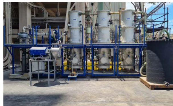
Pilotanlage zur kombinierten Abgasreinigung, Kohlenstoffabscheidung und -konversion.
