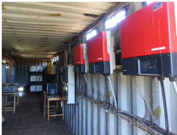
Das A:RT-D Grids-Team vernetzt Stromversorgung.
