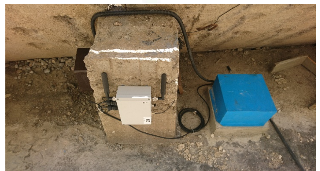
Установка сейсмических датчиков и системы передачи данных в режиме реального времени с использованием технологии WLAN
