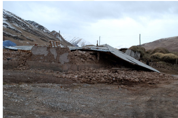
Здание в Кыргызстане, разрушенное землетрясением магнитудой 6,8 балла.
