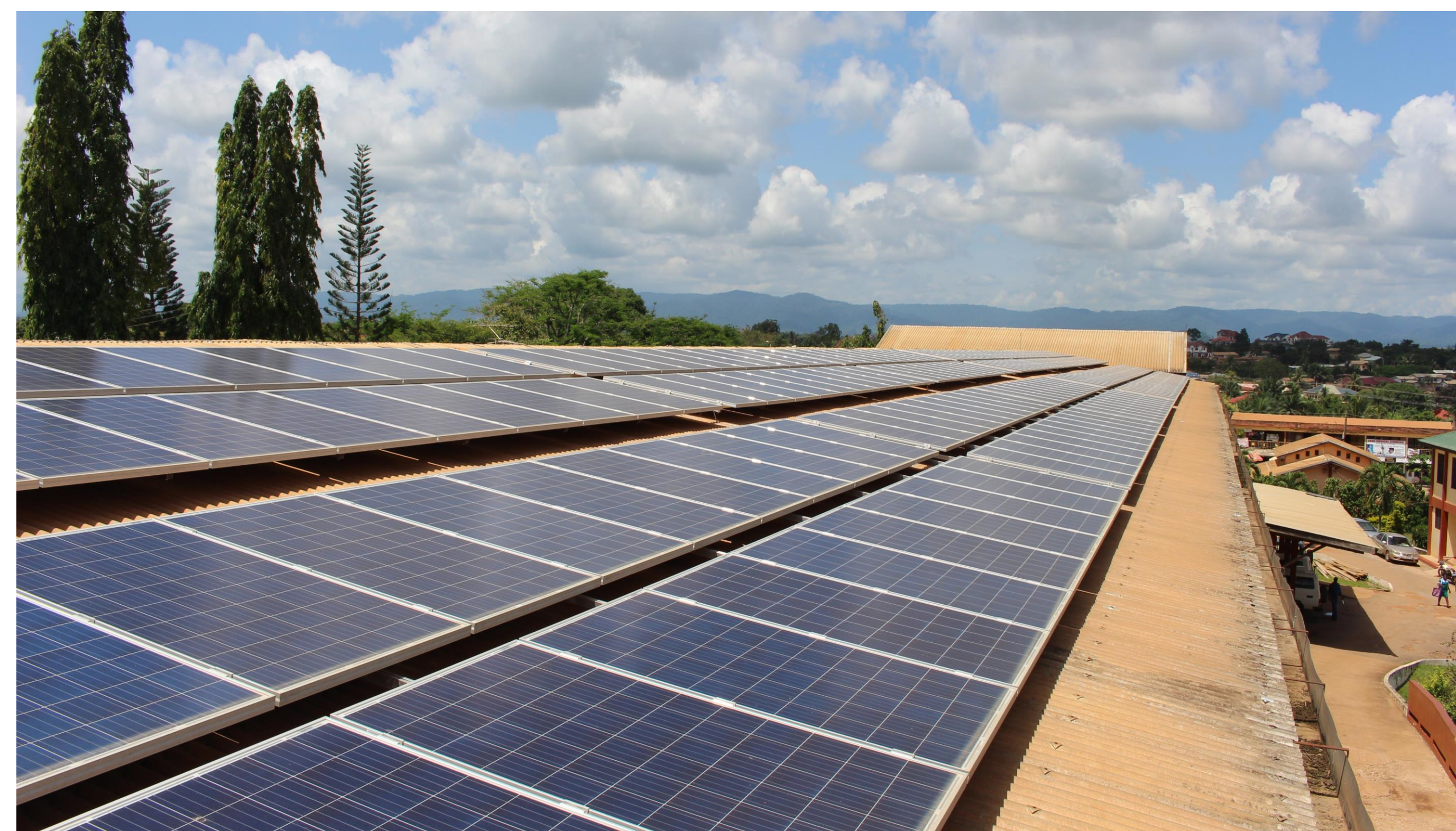
Installierte PV-Module, St. Dominic's Hospital Akwatia, Ghana.
